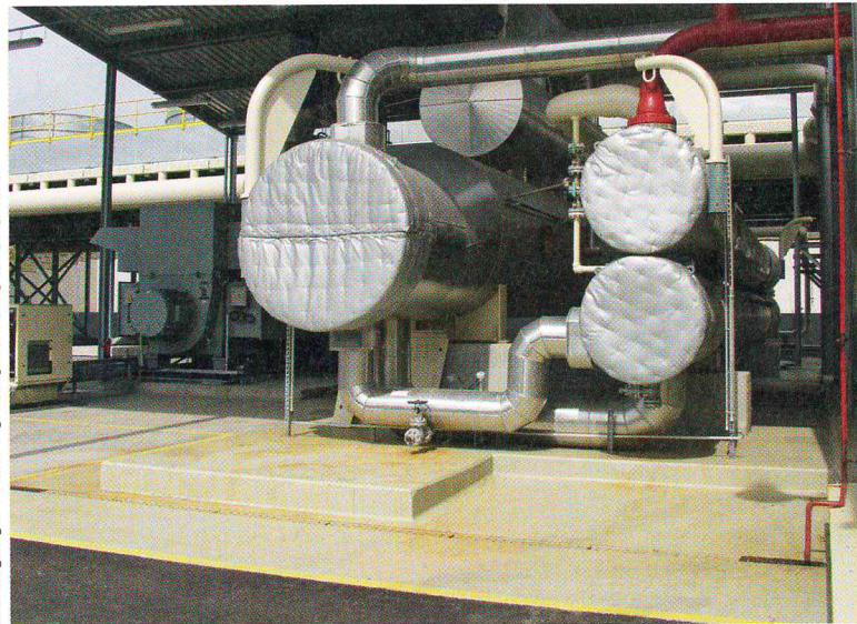
Abb. 2 – In Insheim wird seit etwa einem Jahr Strom produziert. Die Anlage wird kontinuierlich an ihre volle Leistungsfähigkeit herangeführt. Eine Wärmeauskopplung ist in Planung (im Bild: Generator und Verdampfer).
